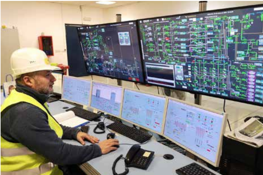
Puesto de operación SCADA FactoryTalk View
